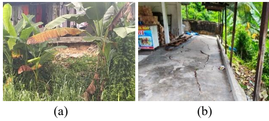
Gambar 1.a. Kondisi Lereng Setelah Longsor, 1.b. Kondisi Bangunan Setelah Longsor
