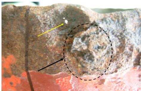
Gambar 8. Detail korosi pada dinding tabung
